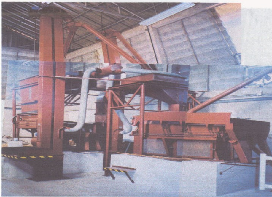
1.1 เครื่องจักรภายในโรงงาน
