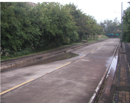
ภาพที่ 2 ตัวอย่างการทรุดตัวของผิวถนนบริเวณที่มีท่อระบายน้ำลอดผ่าน
