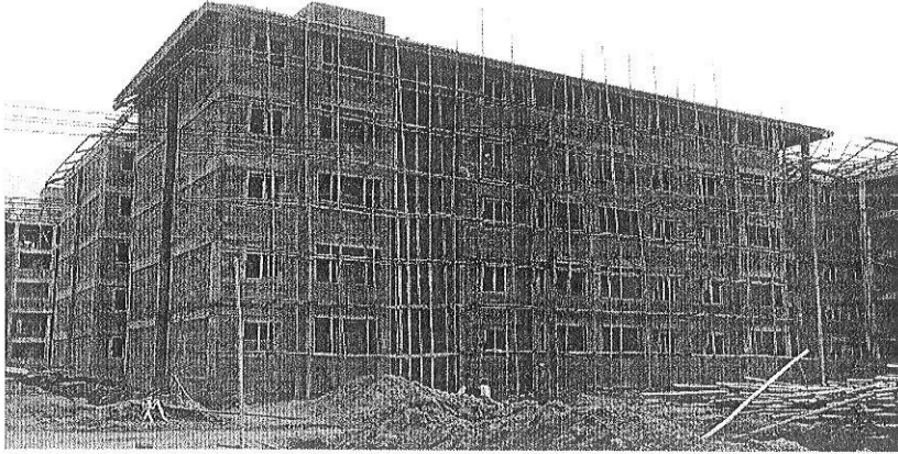
รูปที่ 4.9 ความปลอดภัยในการทำงานก่อสร้างว่าด้วยนั่งร้าน โครงการก่อสร้างที่ 4
