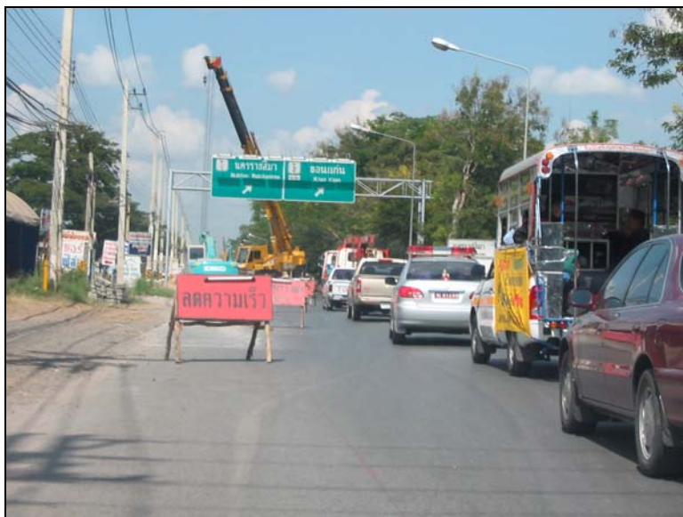
รูปที่ 4.16 การควบคุมจัดการจราจรก่อนเข้าสู่พื้นที่ที่มีกิจกรรมบำรุงสายทางไม่มีประสิทธิภาพ และไม่มีการจัดเตรียมทางเดินเท้าที่เหมาะสม
