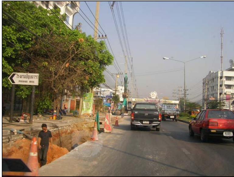
รูปที่ 4.13 อุปกรณ์แนวกั้นในการป้องกันอันตรายต่อผู้ขับขี่ไม่เพียงพอ
