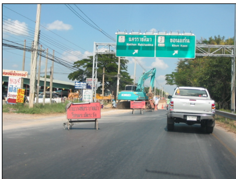
รูปที่ 4.4 ความสูง ระยะการมองเห็น ระยะห่างในการติดตั้งป้ายเตือนไม่เหมาะสม
