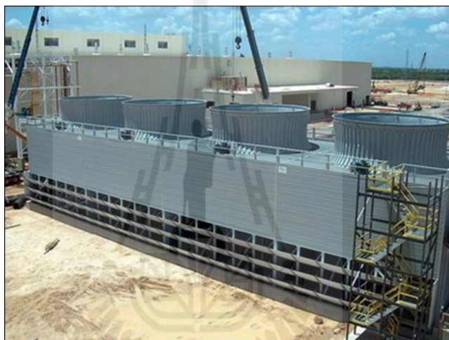
รูปที่ 2.6 Cooling tower ที่ทำจากวัสดุ PFRP (Creative Pultrusions, 2004)
