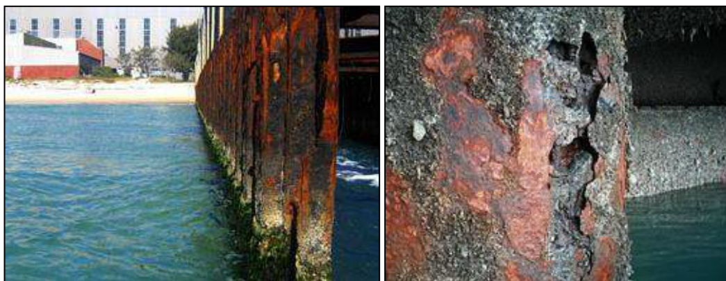
รูปที่ 1.2 โครงสร้างเหล็กรูปพรรณที่เกิดสภาวะกัดกร่อนเนื่องจากสนิม (จักษดา ชำรงวุฒิ และ สิทธิชัยแสงอาทิตย์, 2554)
