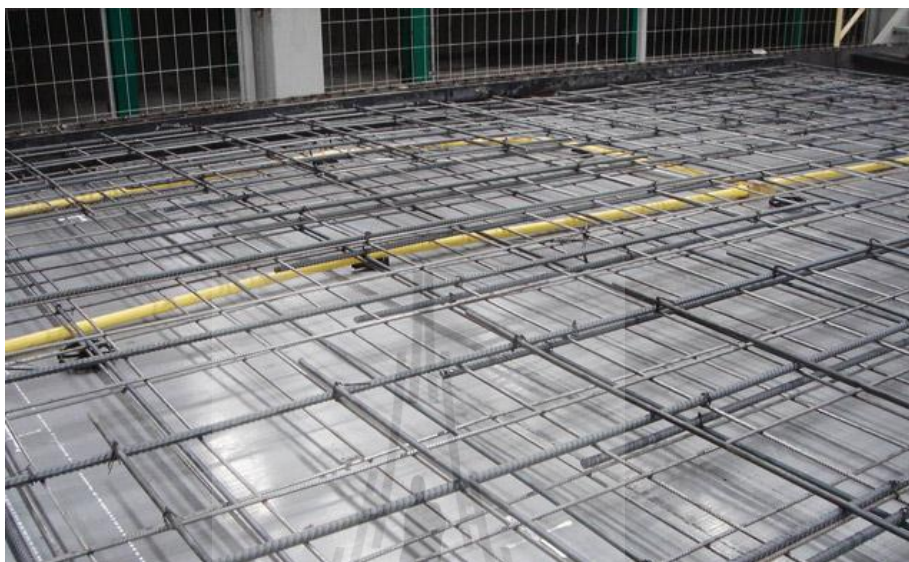
รูปที่ 2.6 การวางอุปกรณ์ และฝังท่อไฟก่อนการเท ( Pruksa Real Estate , 2006)
