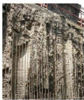
รูปที่ 6 SCC หลุดออกจากกันทำให้เห็นรอยต่อที่ไม่เป็นเนื้อเดียวกับของเสาเข็มดินซีเมนต์
