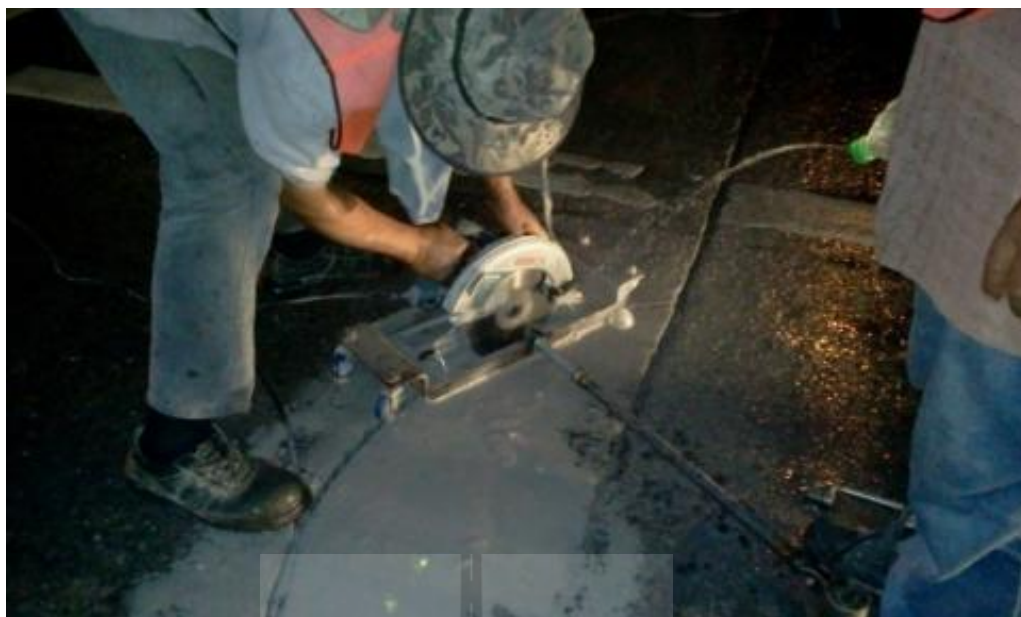
รูปที่ 3.17 เครื่องตัดถนนแบบตัดเป็นวงกลม (3)
