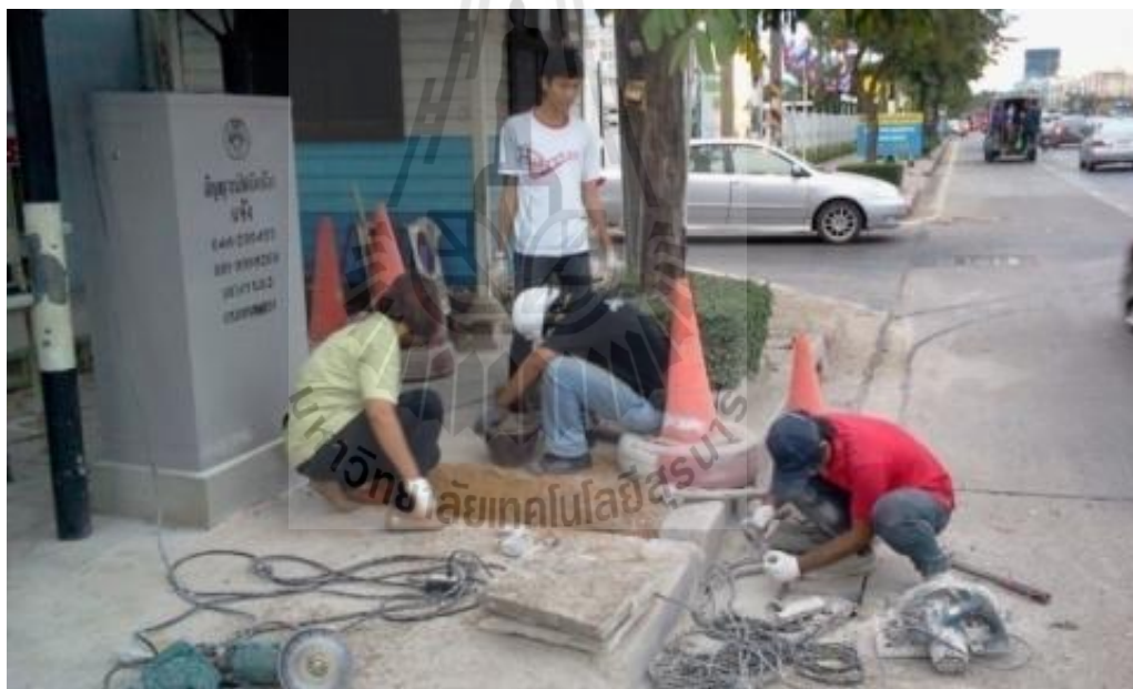
รูปที่ 3.28 การเดินสายไฟเข้าสู่ตู้ควบคุมระบบไฟจราจร (4)
