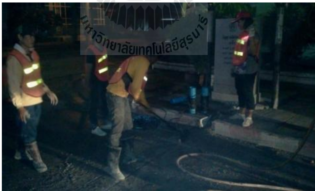
รูปที่ 3.20 การวางสายไฟและคืนสภาพพื้นผิวถนน (2)
