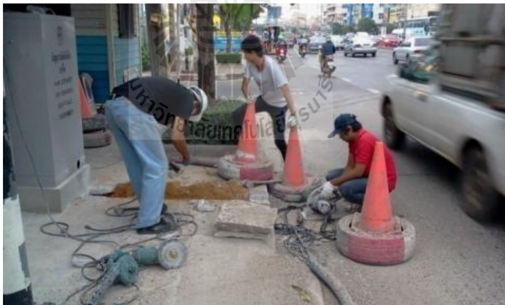
รูปที่ 3.26 การเดินสายไฟเข้าสู่ตู้ควบคุมระบบไฟจราจร (2)
