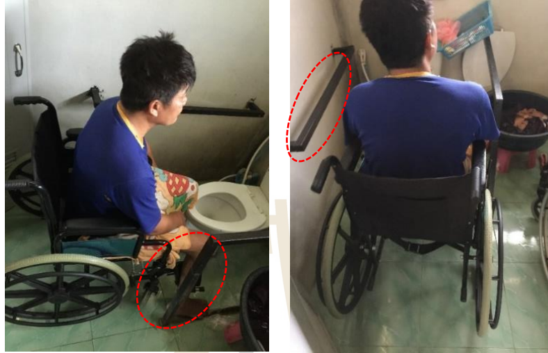
รูปที่ 4.16 ลักษณะราวจับพุงตัวภายในห้องน้ำ
