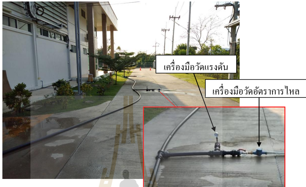
รูปที่ 3.2 ติดตั้งเครื่องมือวัดอัตราการไหล และเครื่องมือวัดแรงดัน
