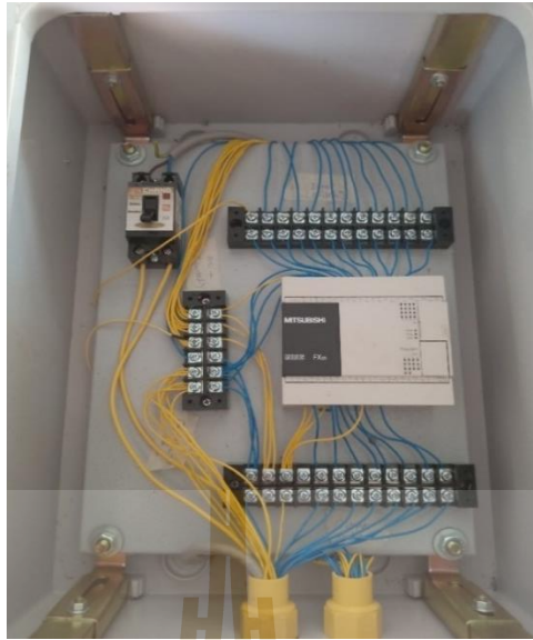
ภาพที่ 4.5 ตู้ควบคุมไฟฟ้าสำหรับควบคุมการทำงานของเครื่องต้นแบบ
