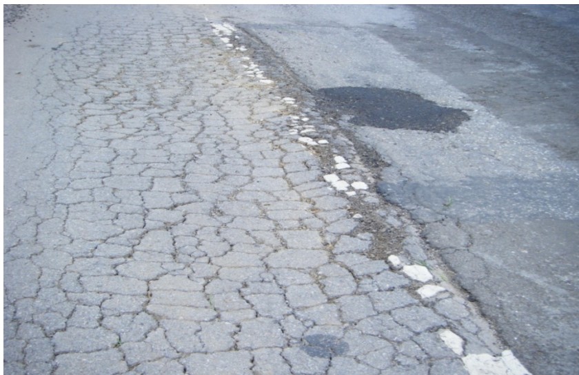
รูปที่ 1.1 สภาพความเสียหายของถนน
