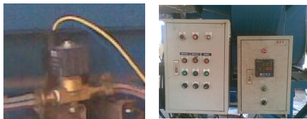
รูปที่ 3-5 ชุดควบคุมความร้อน
