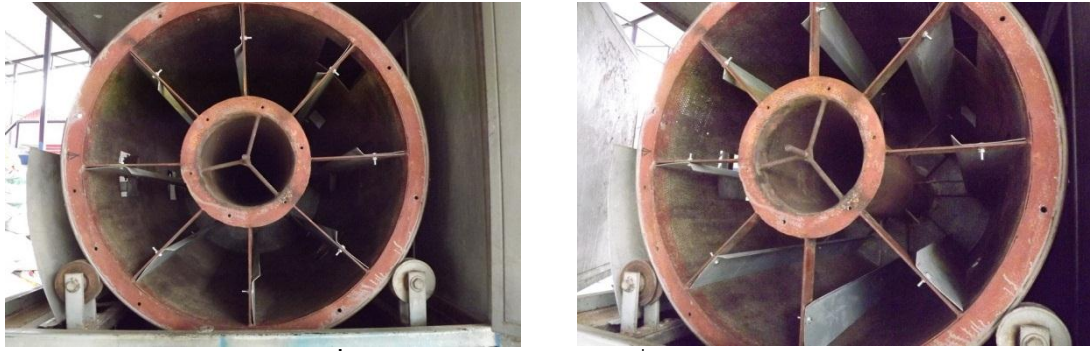
รูปที่ 3-3 ถังทรงกระบอกหมุนที่ปรับปรุงแล้ว
