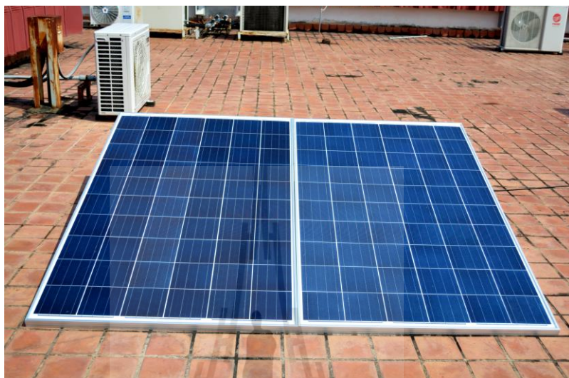
รูปที่ ข.1 แผงเซลล์แสงอาทิตย์ฟิสิกส์ 250 W จำนวน 2 แผง
