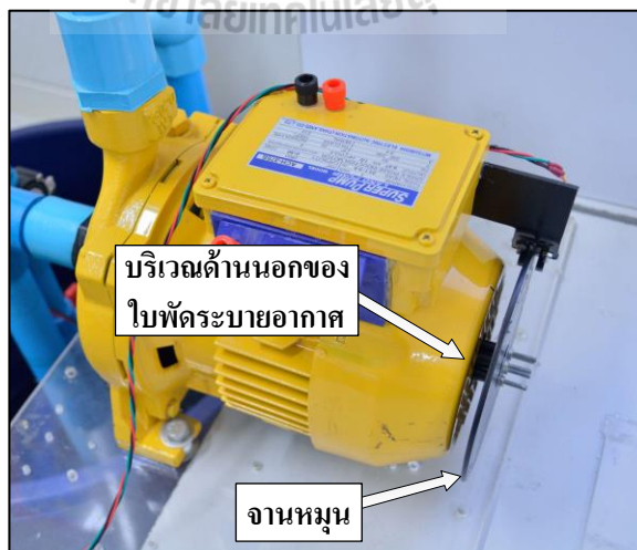
รูปที่ 3.35 ลักษณะการติดตั้งจานหมุนกับมอเตอร์ปั้มน้ำไฟฟ้า
