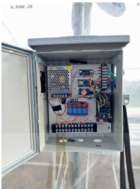
รูปที่ 3.6 ตู้ควบคุมที่ใช้ในการทดสอบ
