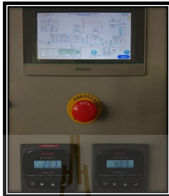
รูปที่ 4.3 แผงหน้าตู้ควบคุม
