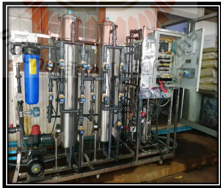
รูปที่ 4.29 ระบบเครื่องกรองน้ำ RO
