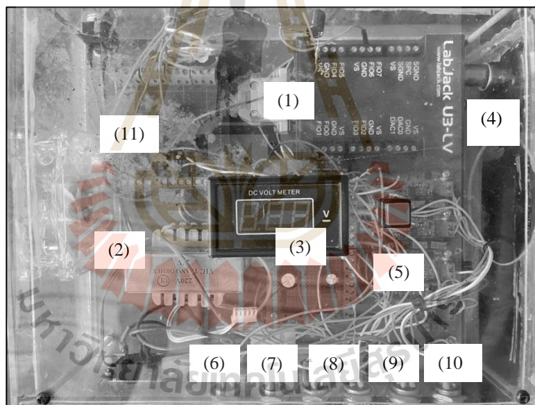
รูปที่ 3.4 อุปกรณ์ไฟฟ้าภายในกล่องควบคุม
